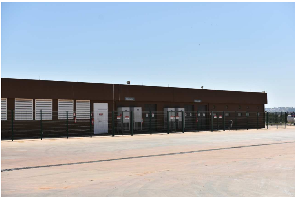
Foto 58 – Subestação de Energia
