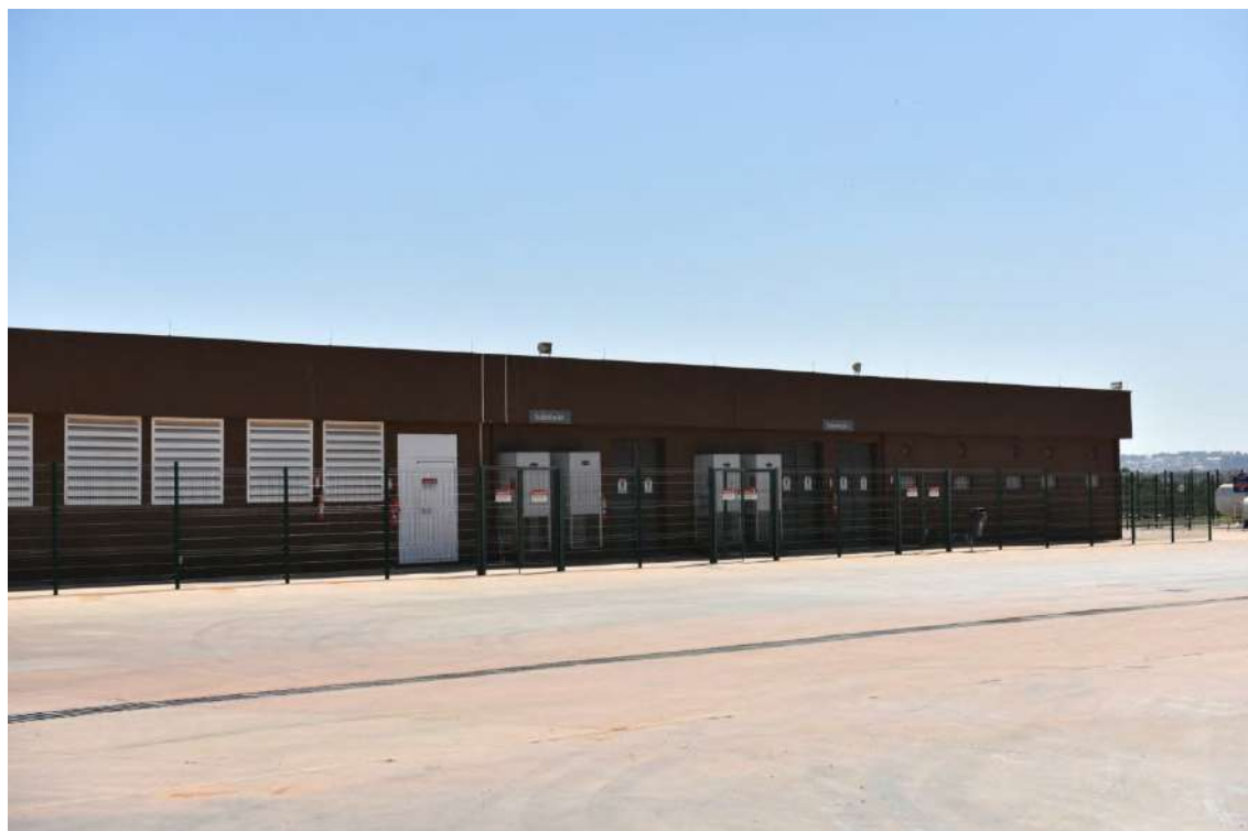
Foto 58 – Subestação de Energia
